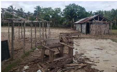
Ecole de Mahatsara après les cyclones de 2022
